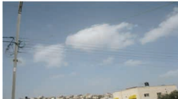
كوابل كهرباء مكشوفة في قباطية
