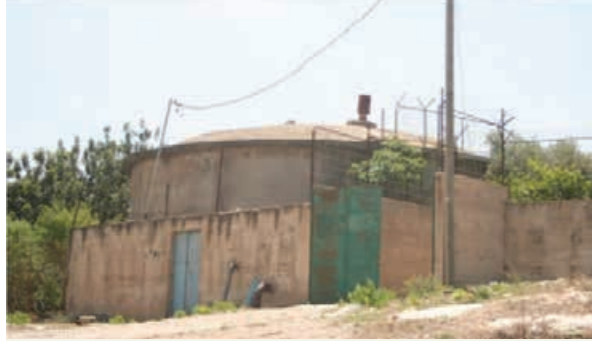
خزان مياه قديم بحاجة لاعادة تأهيل-قباطية
