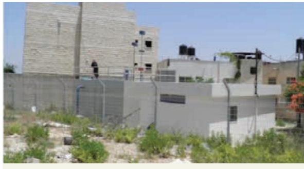
محطة تعزيز ضخ المياه في قباطية
