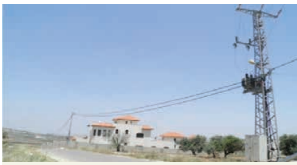
خطوط شبكة كهرباء - قباطية
