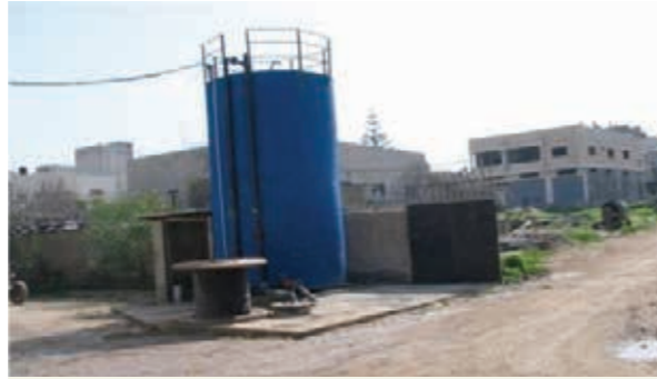
محطة تعزيز ضخ المياه في قباطية
