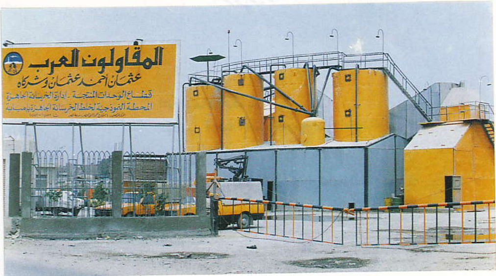
صورة رقم (١) توضح عدد ٤ صوامع لتخزين الأسمنت السائب بمحطة خلط خرسانه مركزية لإنتاج الخرسانه الجاهزة
