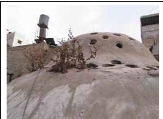
شكل (٣) القبة الرئيسية، تظهر القسارة الإسمنتية والنباتات التي تعيش عليها، كما تظهر الفتحات خالية من الزجاج وتسمح بتسرب مياه المطر إلى الداخل تصوير الباحث، ١٩٩٩
