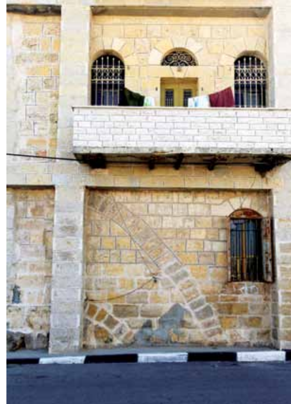
بلكنونة المبنى (G3) والتي تم إزالة معظم عناصرها ولم يتبق سوى الدوامر الحديدية واستبدل حديد الحماية بمواد حديثة لا تتناسب والقيمة التاريخية للمبنى
