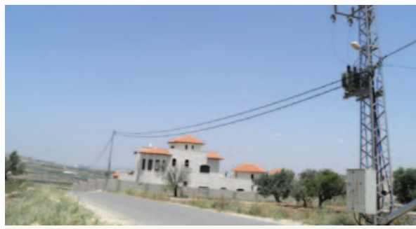
خطوط شبكة كهرباء - قباطية
