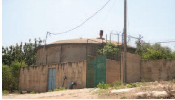
خزان مياه قديم بحاجة لاعادة تأهيل-قباطية
