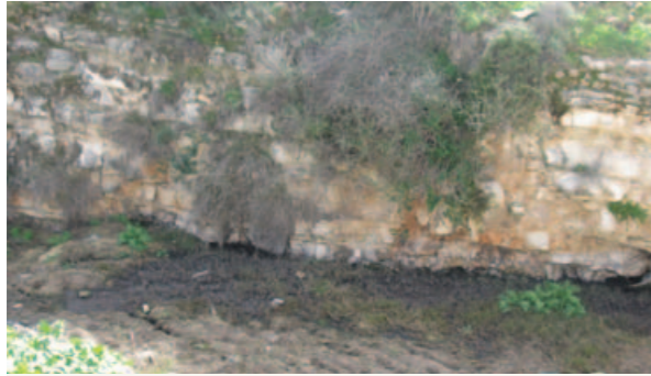
مقلع حجر قديم في قباطية يستخدم كمكب لمياه الصرف الصحي
