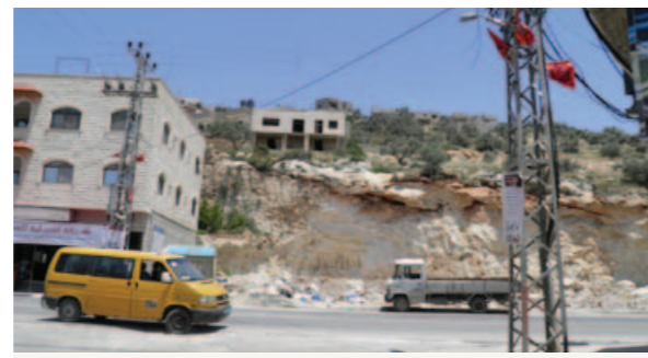
خطوط شبكة كهرباء - قباطية
