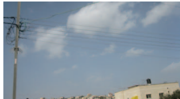
كوابل كهرباء مكشوفة في قباطية
