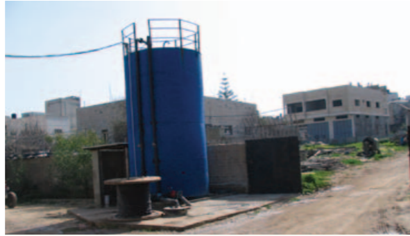
محطة تعزيز ضخ المياه في قباطية
